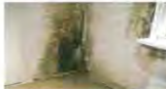
Bauschäden (in einem Innenraum (Schimmelbildung))
